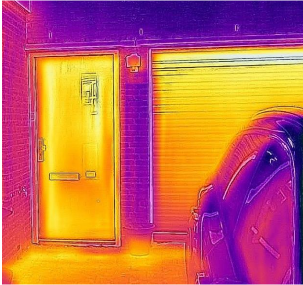
Garagedeur niet geïsoleerd
